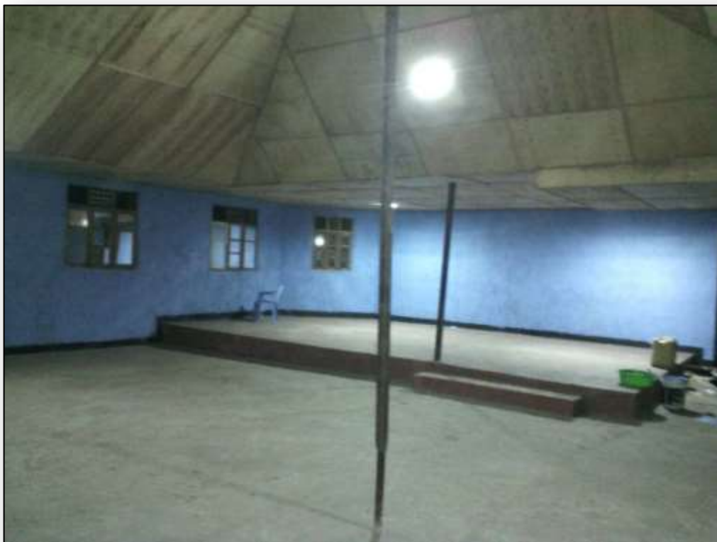
La sala principale tinteggiata e con l'impianto elettrico in funzione
